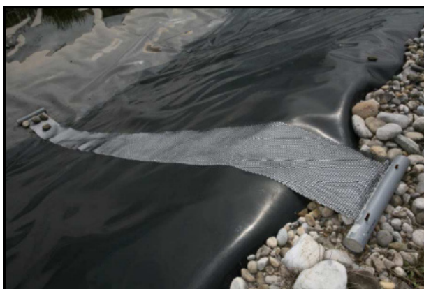
Photo 33 : Echappatoire installé sur un bassin équipé d'un dispositif d'étanchéité par géomembrane.
